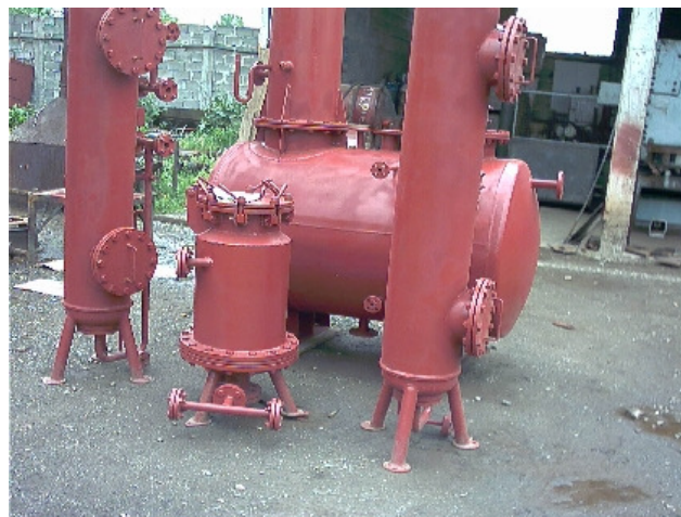
Priprema kotlovske vode
